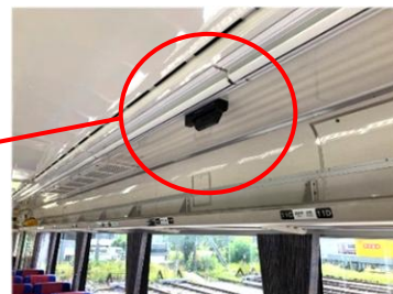
＜車内の設置状況＞
