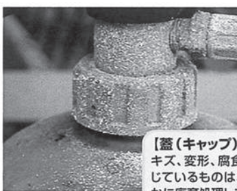
あばた状の腐食
