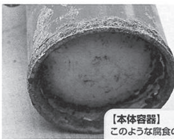
溶接部とその周辺の腐食
