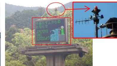
放流警報設備
