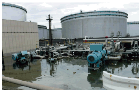
冠水した製油所敷地 (2019年10月台風)
