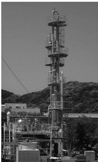
図12 松島火力発電所試験設備
