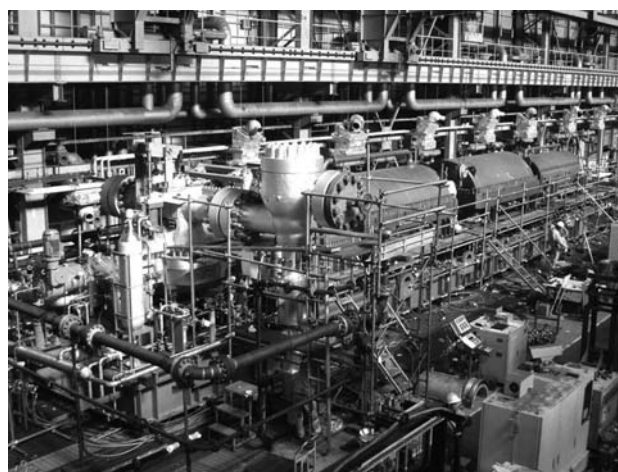
写真1 分解ガス圧縮機トレーン
