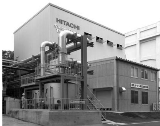
図10 蒸気タービン実証試験設備
