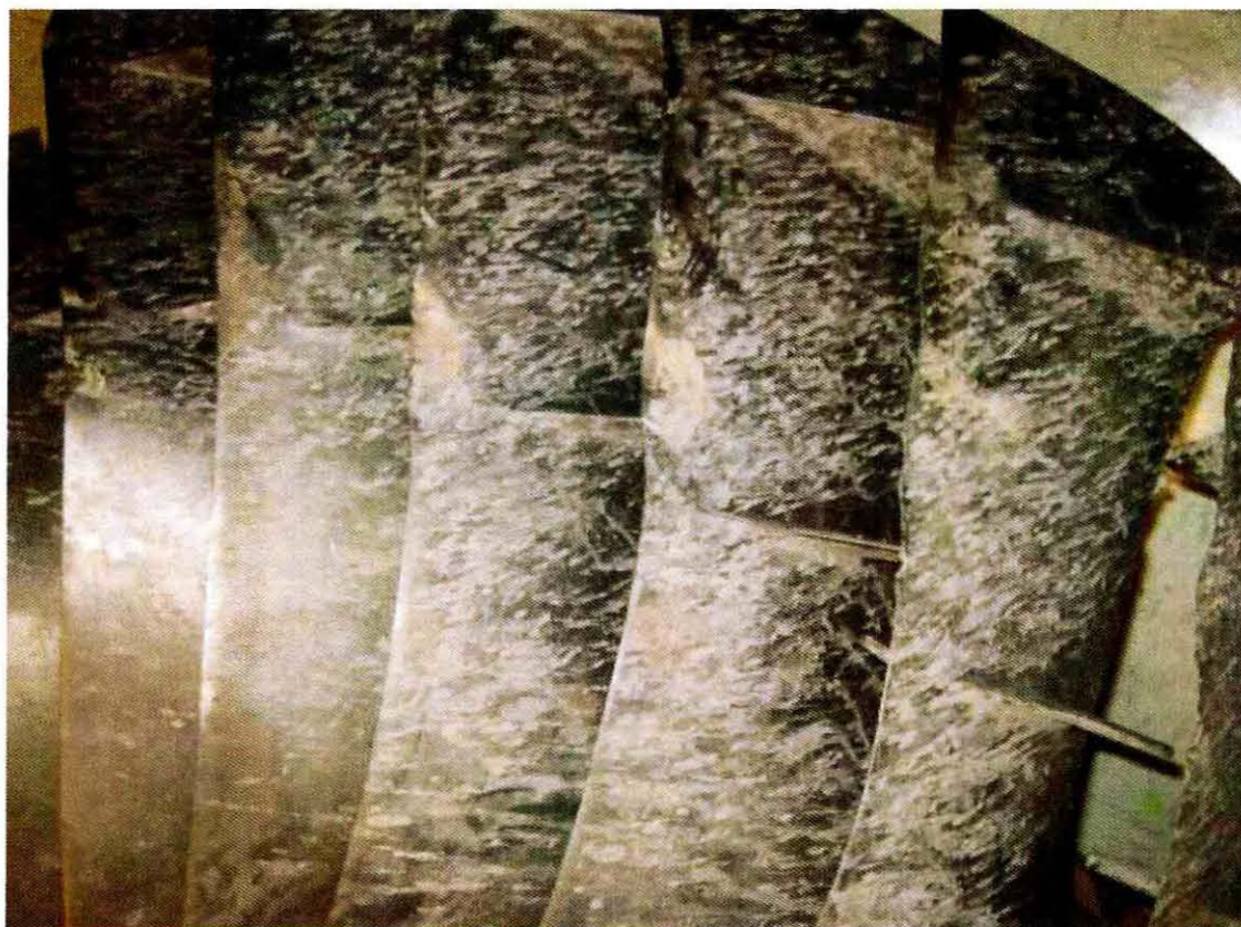
Estado de los álabes Motor 2
