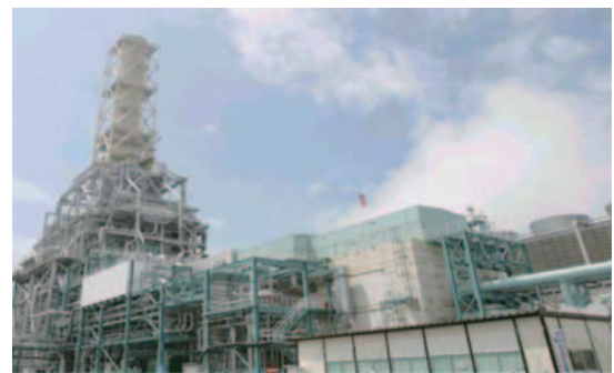
図9 VR-IGCC複合発電設備全景
