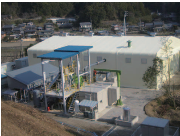
図10 木質バイオマスガス化発電システム（手前）およびペレット製造設備（奥）
