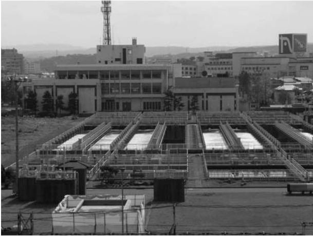
写真2 八戸市下水処理場
