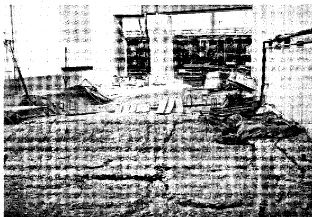
図6 配管ピット陥没
