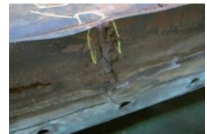
フランジボルト穴の貫通き裂
