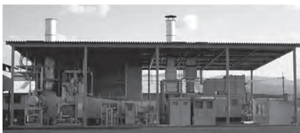
注：右側がガスタービン発電装置、ダンパを挟んで左側が水管式排熱ボイラ
