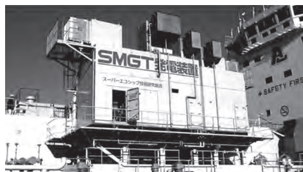
図 6.36 スーパーマリンガスタービン発電装置の外観 (16)
