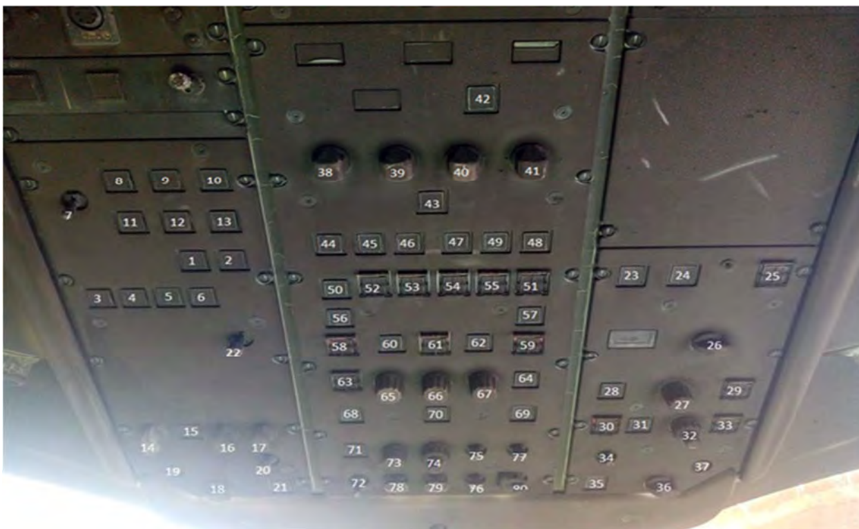
Рис. 22. Состояние кнопок аккумуляторных батарей после АП
