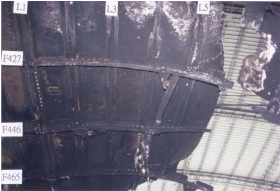
圖1.12-5 爆炸裂開區在框架站位附近的結構蒙皮外觀
