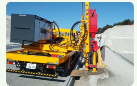
同時に導入した削岩機を取り付ければ、それまで外注していた岩盤の削孔もできる。
