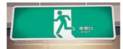
非常口表示板
