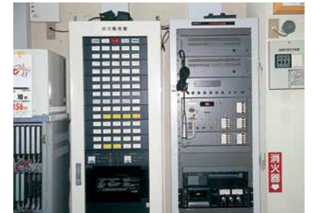
火災警報装置
