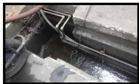
配管 ⇒ 異常無し
