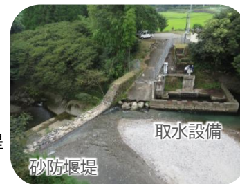
【砂防堰堤の活用例】 菊鹿発電所取水設備 (上内田川第二砂防堰堤から取水)
