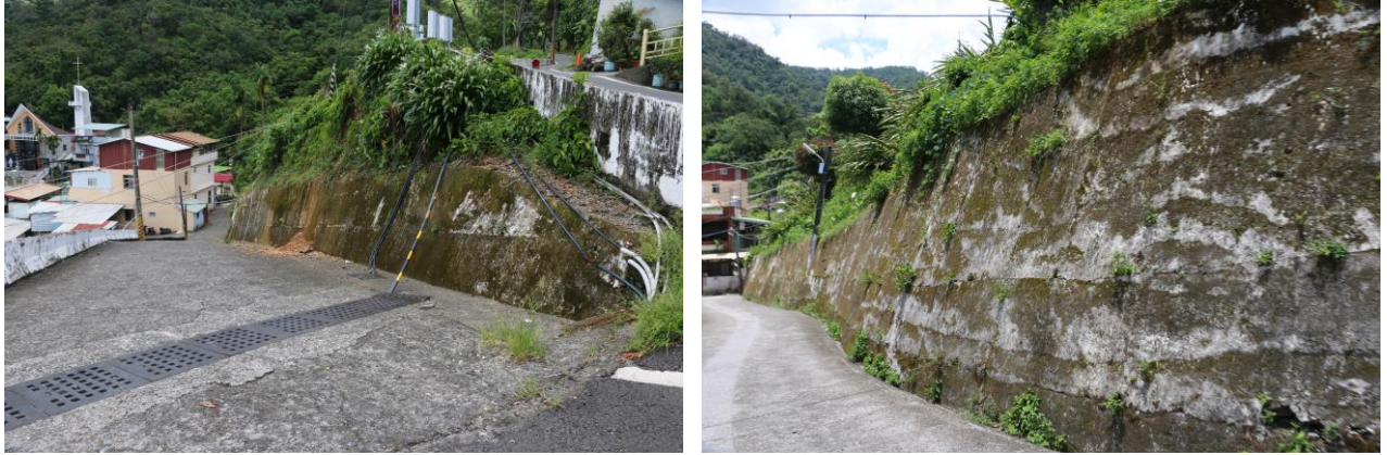
圖 4- 2 武潭社區聚落外牆現況
