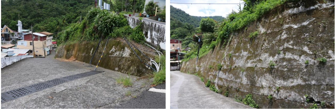
圖 4- 2 武潭社區聚落外牆現況
