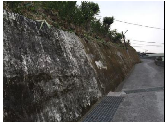
圖 4- 17 武潭社區排水設施
