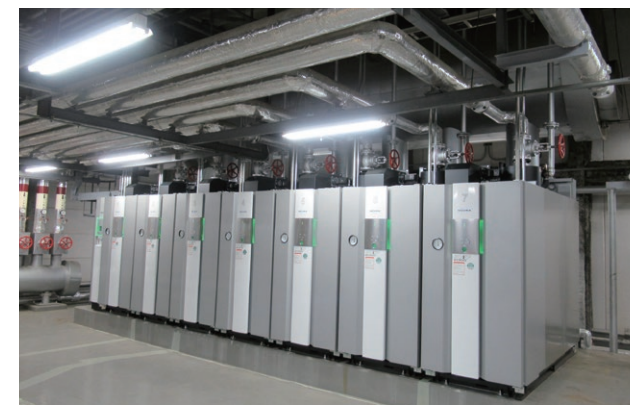
ガス焼き貫流ボイラー(持田製薬工場(株)本社工場)
