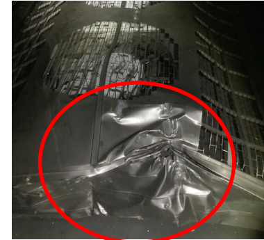
④空調装置損傷
