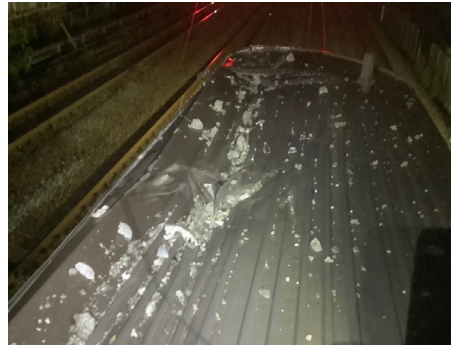
③屋根損傷
