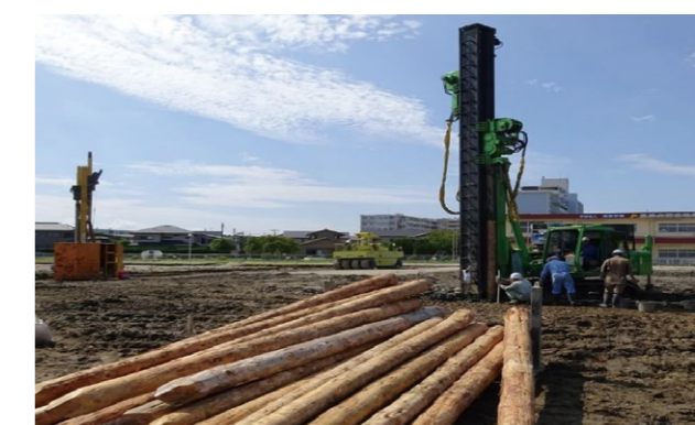
カーボンストック工法 施工風景 ※木材活用地盤対策研究会より提供
