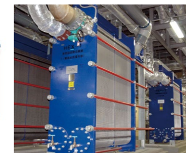
排水の排熱利用に使用する熱交換器
