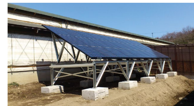
農場内にある太陽光発電設備
