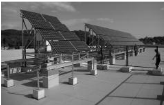
長橋小学校屋上に設置された太陽光パネル
