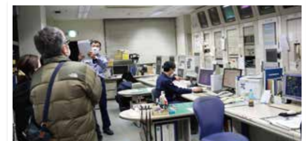
中央監視室の見学 設備専門のスタッフが24時間常駐し、水族館の全ての設備、空調をコントロールしています。
