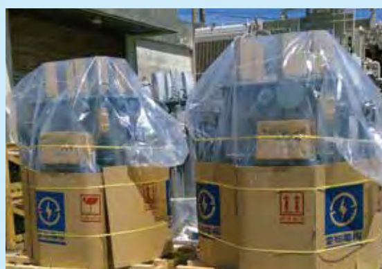
高圧自動電圧調整器 (SVR)
