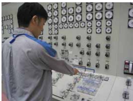
不要直流負荷 切離し操作（中央制御室）
