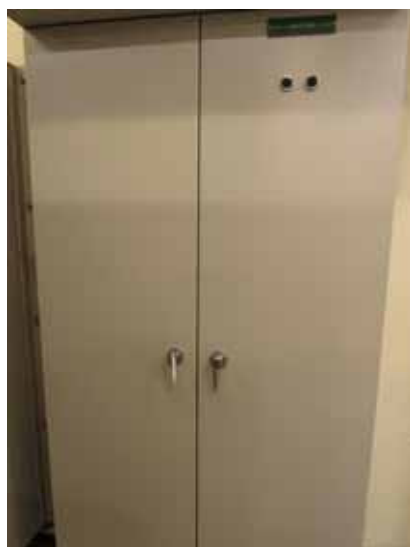
Bリレー室直流分電盤
