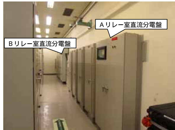
1次系継電器室
