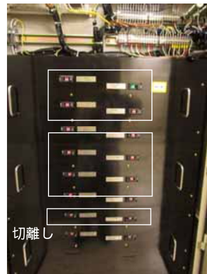
切離し対象遮断器（NFB） （Bリレー室直流分電盤）
