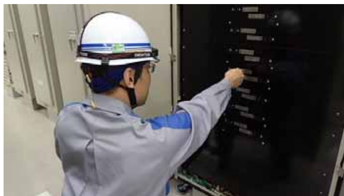
不要直流負荷 切離し操作（現場）
