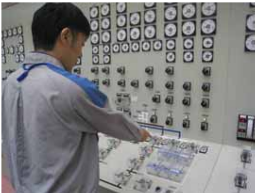
遠隔切離スイッチ（中央制御室）
