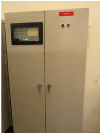
Aリレー室直流分電盤
