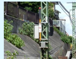
▲ 落石検知装置の設置
