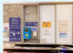
▲ 駅遠隔監視システム
