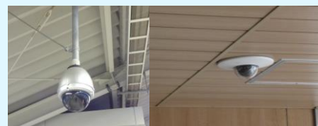
▲ 駅構内監視カメラ (全駅設置)
