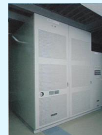
▲ 電力回生インバータ装置 (羽田変電所)
