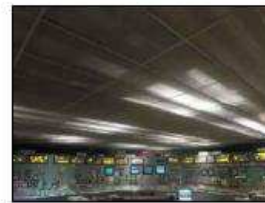
(直流非常灯点灯状態)
