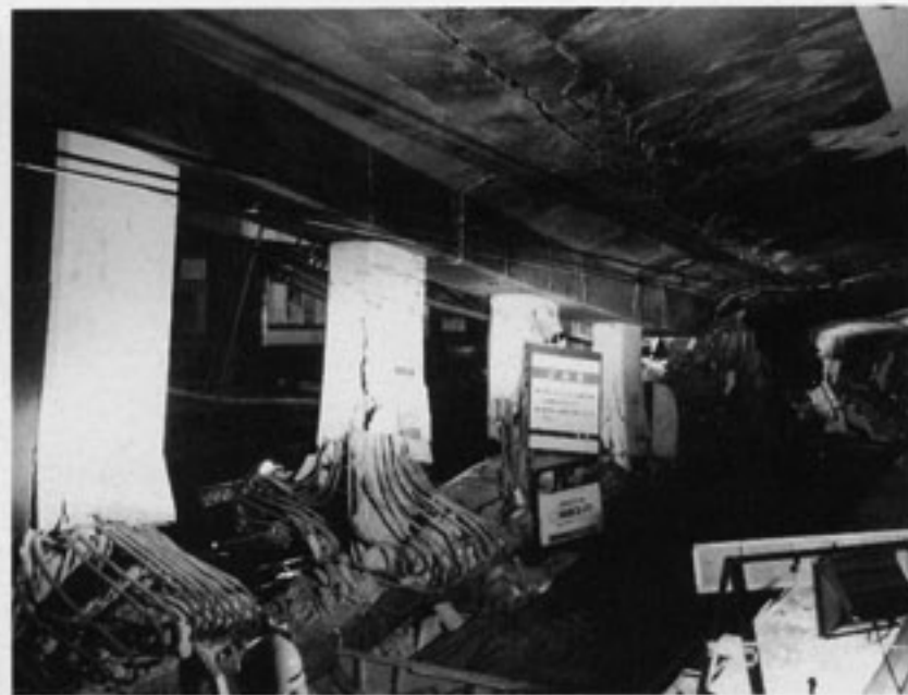
▲大開駅 軌道階、中柱の下部の破壊状況
