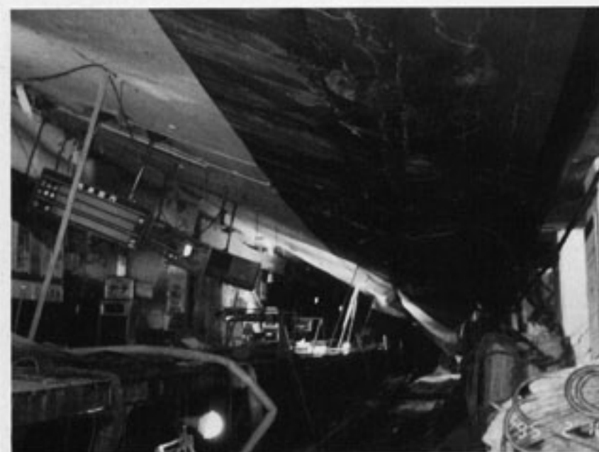
▲大開駅 軌道階、上床落下状況
