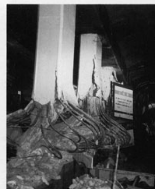
▲大開駅 軌道階、中柱の下部の破壊状況
