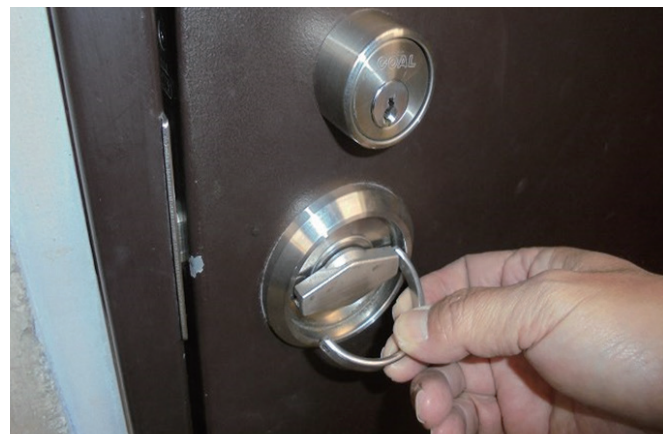
建具(ハンドル破損)
