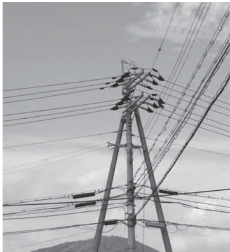
電力送電線から電気を各家庭に
