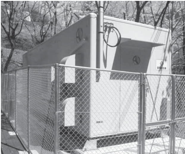
地上デジタル中継施設 (二川ダム公園内)
