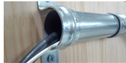
既設配管にて 追張り配線可能
