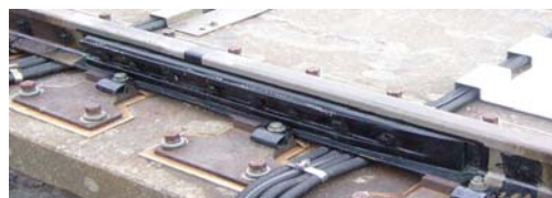
改良後の接着絶縁継目
