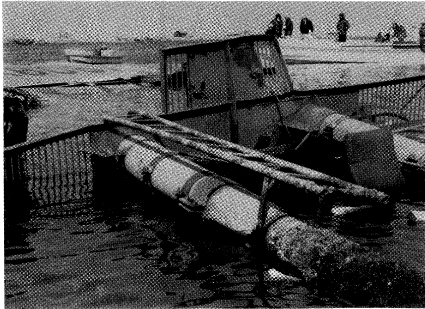
写真 1 4 第 1 8 番進入灯損壊状況
