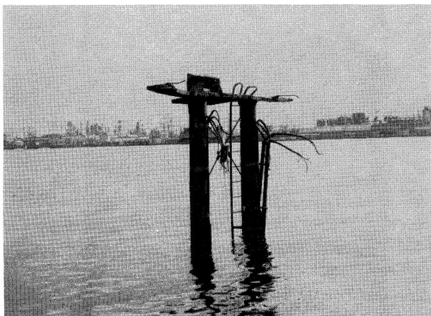
写真 1 0 第 1 4 番進入灯損壊状況（側面）
