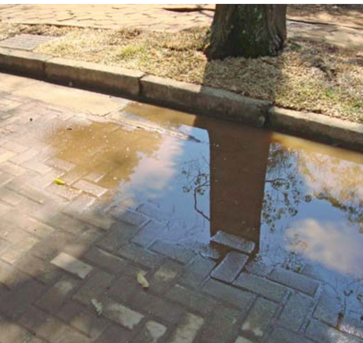
Figura 14 - Pavimento permeável com colmatação das juntas devido ao acúmulo de sedimentos
