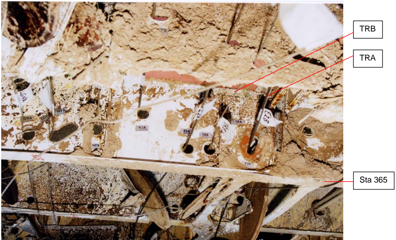
Figura 28.1 –Cables del motor N° 2 debajo del piso
