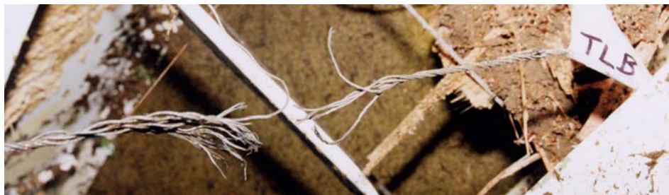
Figura 28.2 – Daños al cable TLB
