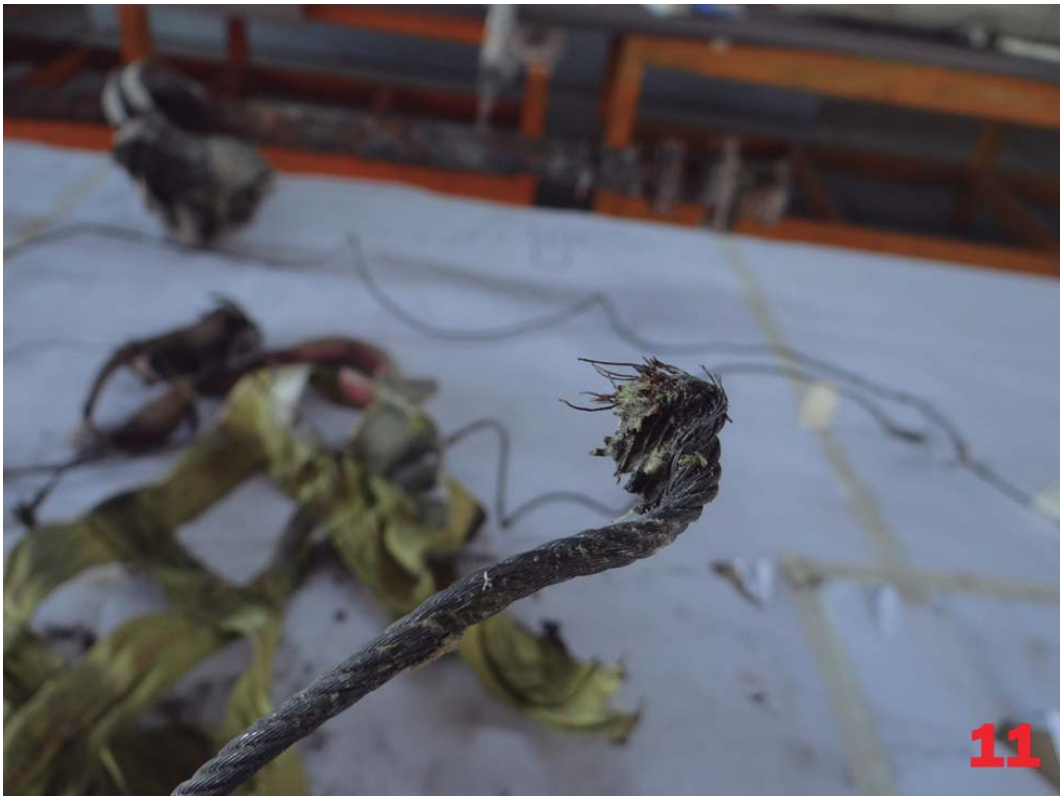
Cable fraccionado e impregnado con material sintético derretido y adherido en el extremo.
