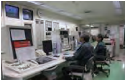
防災センター(栄管理センター)
