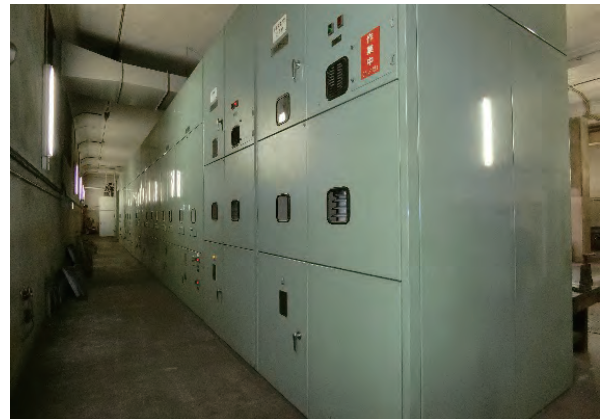
変電設備(気中30kvキュービクル)
