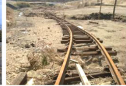
B【線路流失】 しゆのへ りくちゅうやぎ (八戸線 宿戸～陸中八木)
