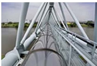
高圧ガス導管
