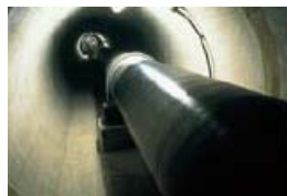
高圧ガス導管
