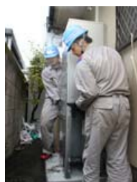
機器設置の様子
