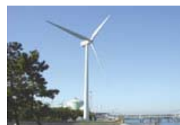
袖ヶ浦LNG基地内の風力発電設備
