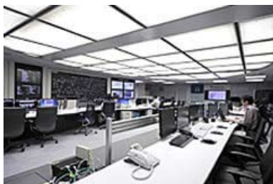
供給指令センター
