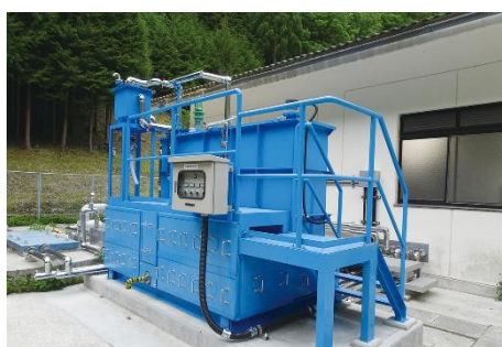
兵庫県佐用町奥海浄水場 MIEX 処理システム
