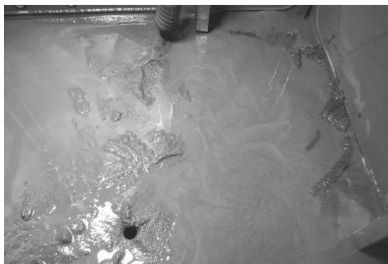
【写真Ⅲ4.1.3-3】夏期隊員宿舎 屋外貯水槽内泥だまり状況
