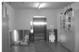
物流用エレベーター
