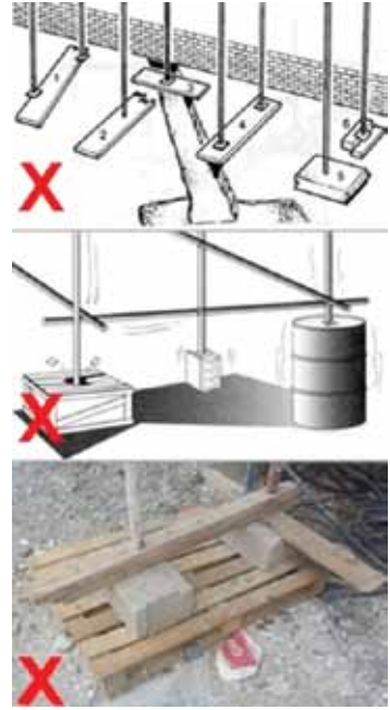
Şekil 3: Uygunsuz iskele tabanları
