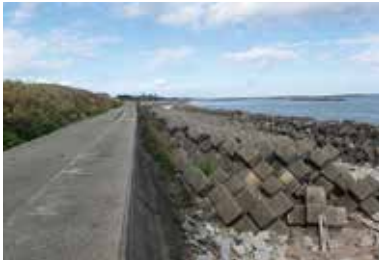
図1 侵食で砂浜がなくなった海岸(福島)
