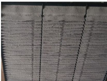
フィルターの汚れ
