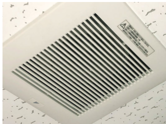
天井の換気口の汚れ
