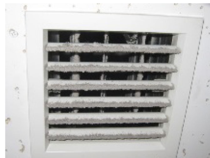
換気口（排気口・給気口）の汚れ
