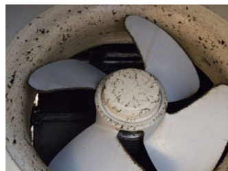
換気扇の汚れ
