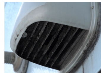
外壁の換気口の汚れ
