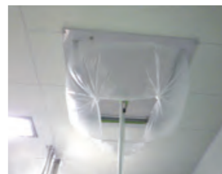
▲HEPA吹出面養生・測定プローブ
