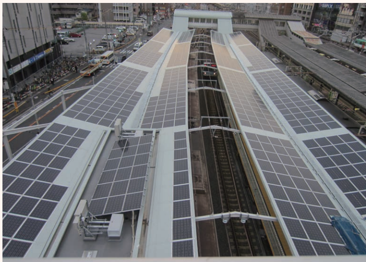
▲西船橋駅における太陽光パネル
