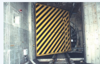
▲坑口浸水対策（防水ゲート）
