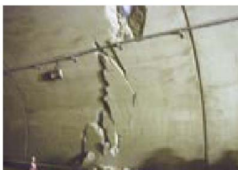
洞爺トンネル覆工コンクリートの損傷
