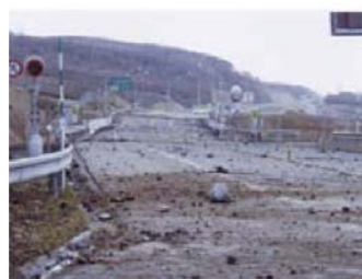
洞爺トンネル東坑口付近の噴石
